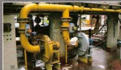
Expertise sur site de ventilateur
