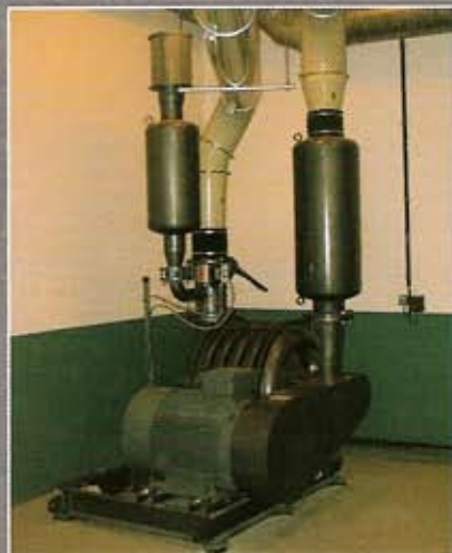
Installation réseau d'aspiration haute dépression
